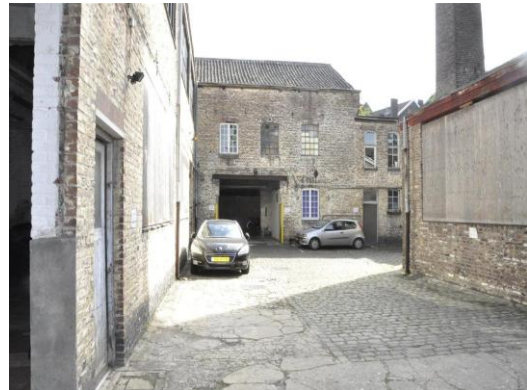
In slechte staat verkerende bedrijfsgebouwen
